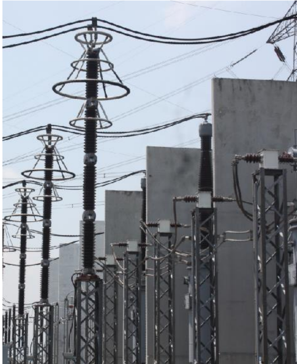
Gambar 4.7 Lightning Arester untuk melindungi trafo daya
