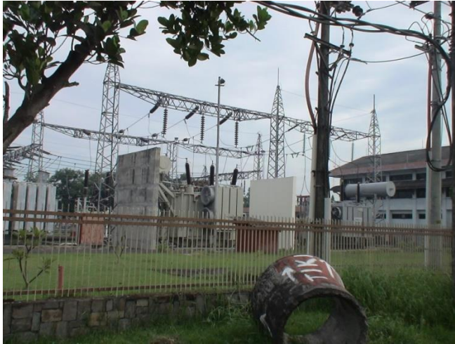
Gambar 4.1 Gardu induk tipe pemasangan luar
