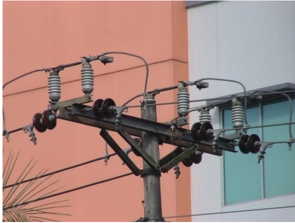
Gambar 5.4 Switch pada jaringan distribusi
