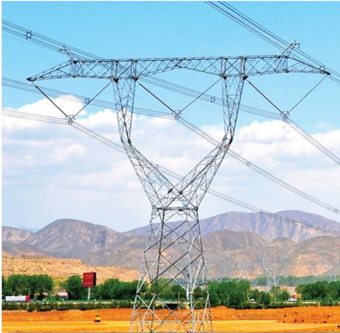
Gambar 3.6 Saluran udara tegangan ultra tinggi
