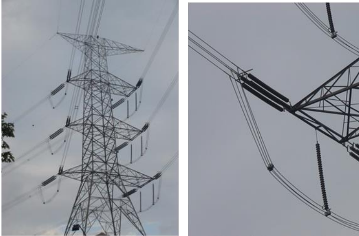
Gambar 3.5 Saluran udara tegangan ekstra tinggi dan isolator gantung
