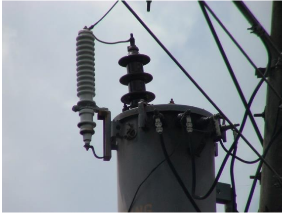
Gambar 5.5 Arester sebagai pengaman trafo distribusi
