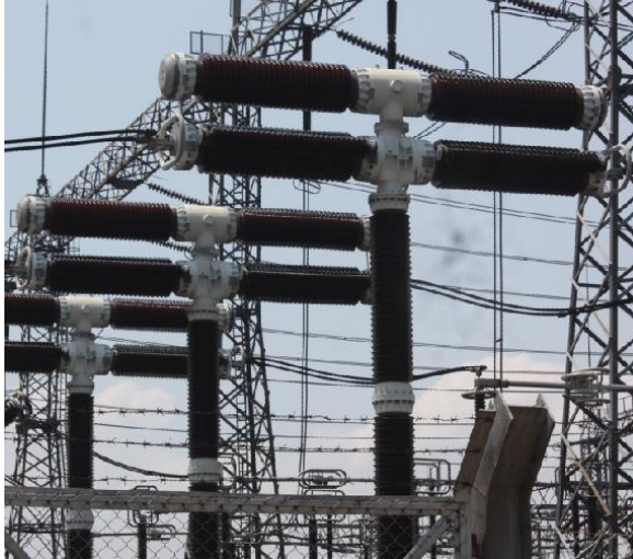
Gambar 4.5 Pemutus tenaga tegangan tinggi dengan SF6
