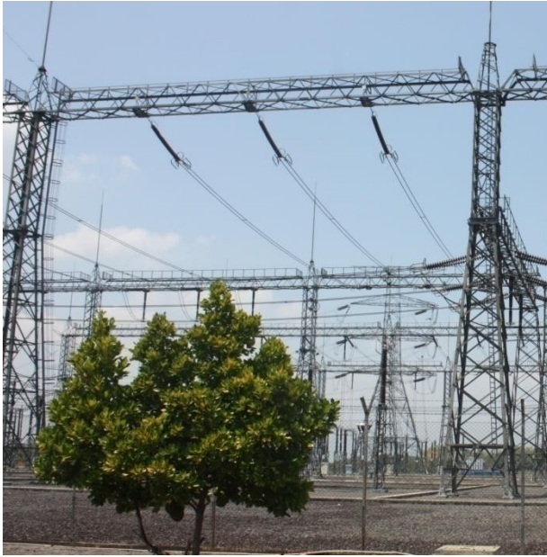
Gambar 4.11 Burbar gardu induk 150 kV
